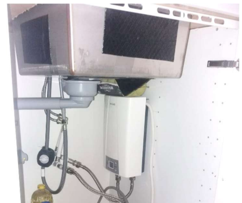
De meterkast: alleen een doorstroomboiler
